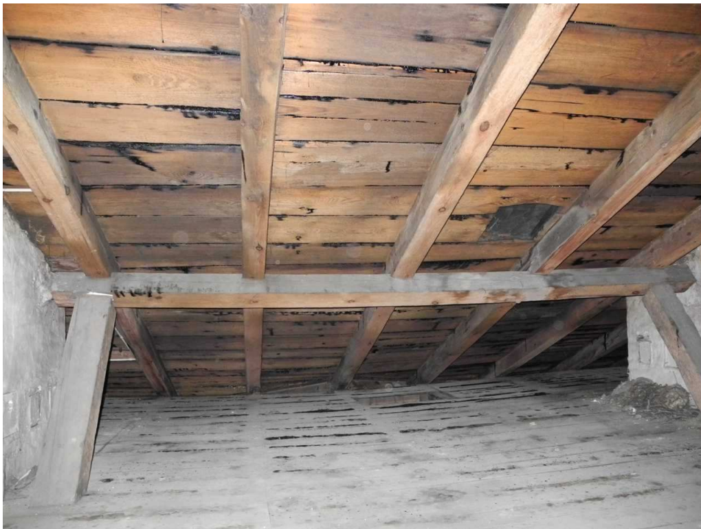
Fot. 18 strych poziom II - ugięcie płatwi
