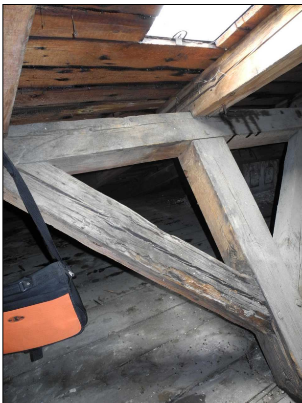
Fot. 16 strych poziom II – uszkodzenie miecza
