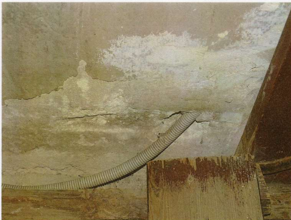
Fot.41 Uszkodzenia przyziemia oraz widoczne osłony przewodów instalacyjnych
