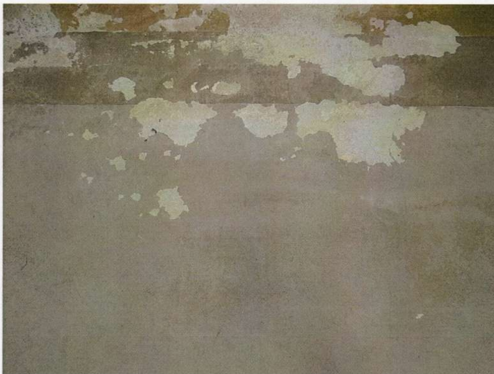
Fot.32 Uszkodzenia i przebarwienia spowodowane kondensacją pary wodnej
