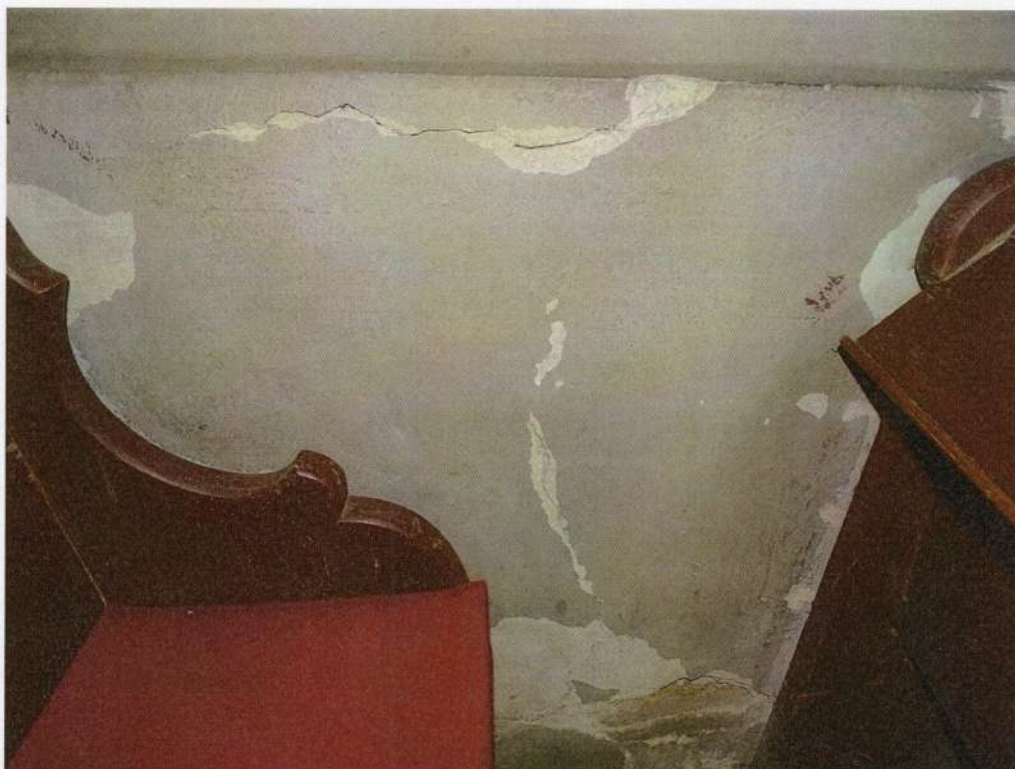
Fot.37 Rysy i pęknięcia części przyziemia w przyziemiu nawy północnej
