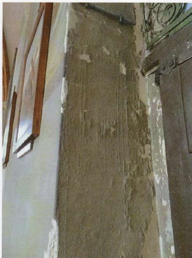
Fot.38 Uszkodzenia, rozwarstwienia i złuszczenia warstwy malarskiej
