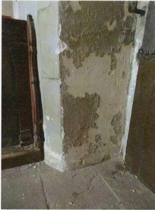
Fot.39 Uszkodzenia, rozwarstwienia i złuszczenia warstwy malarskiej
