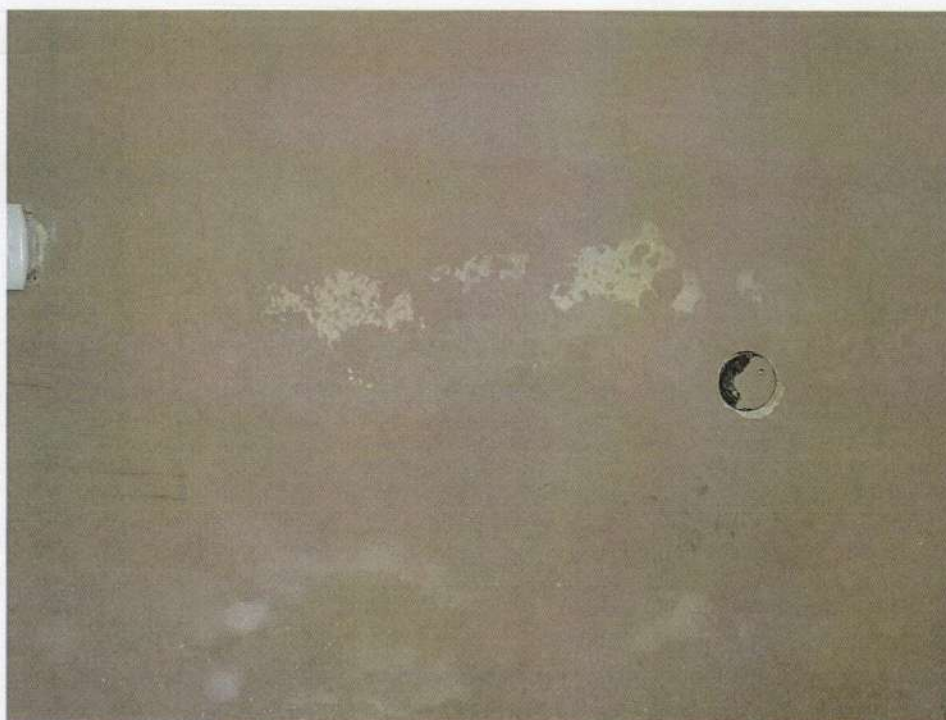
Fot.30 Plamy i przebarwienia spowodowane zawilgoceniem i zasoleniem
