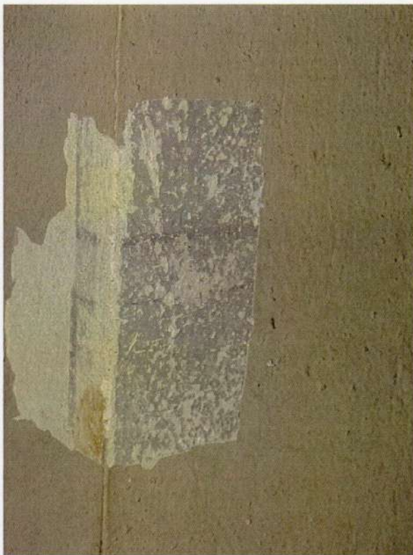
Fot.25 Odkrywka 13. Ściana wschodnia nawy północnej w okolicy wejścia do zakrystii z dekoracją malarską w formie imitacji boniowania
