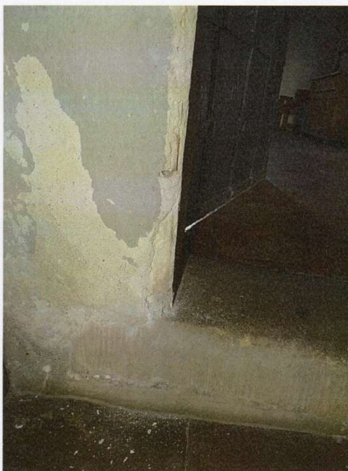
Fot.42 Uszkodzenia mechaniczne przy wejściu do zakrystii
