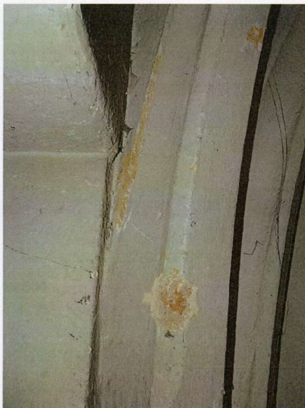
Fot.27 Odkrywka 15. Żebra sklepienne w kaplicy Bożywojów z widoczną kształtką ceglana w miejscu uszkodzenia mechanicznego
