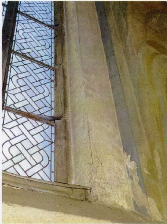
Fot.33 Uszkodzenia w okolicy gliców okiennych
