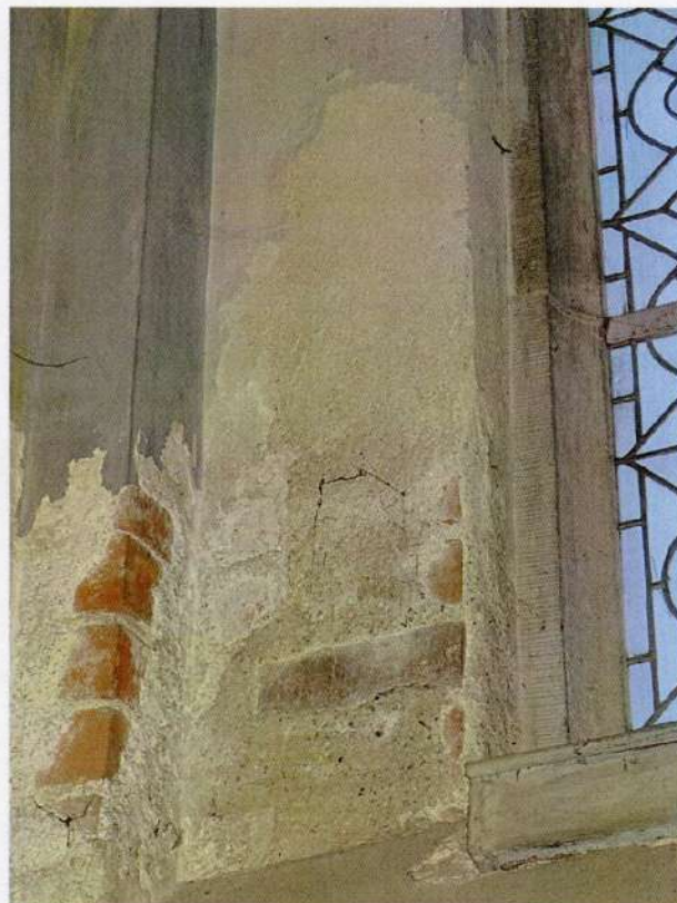
Fot.34 Uszkodzenia w okolicy gliców okiennych
