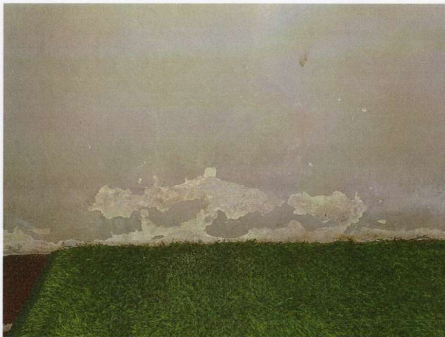
Fot.29 Uszkodzenia części przyziemia spowodowane zawilgoceniem i zasoleniem nawy południowej
