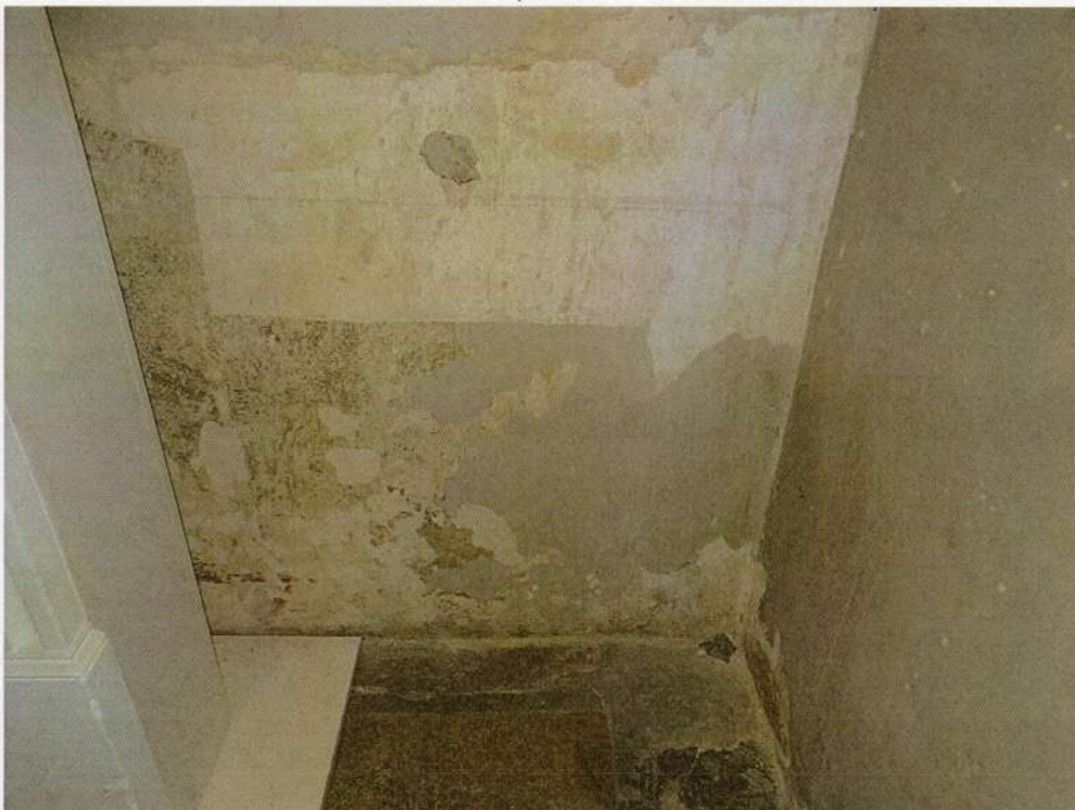
Fot.44 Uszkodzenia przyziemia w części wschodniej nawy północnej
