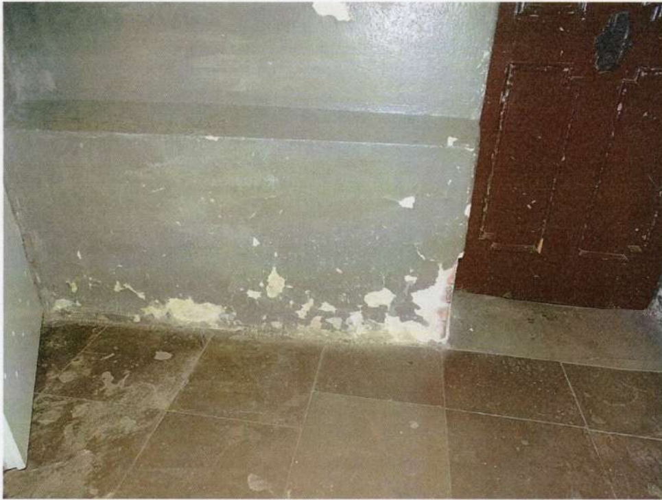
Fot.47 Uszkodzenia tynku i warstw malarskich w kaplicy Bożywojów
