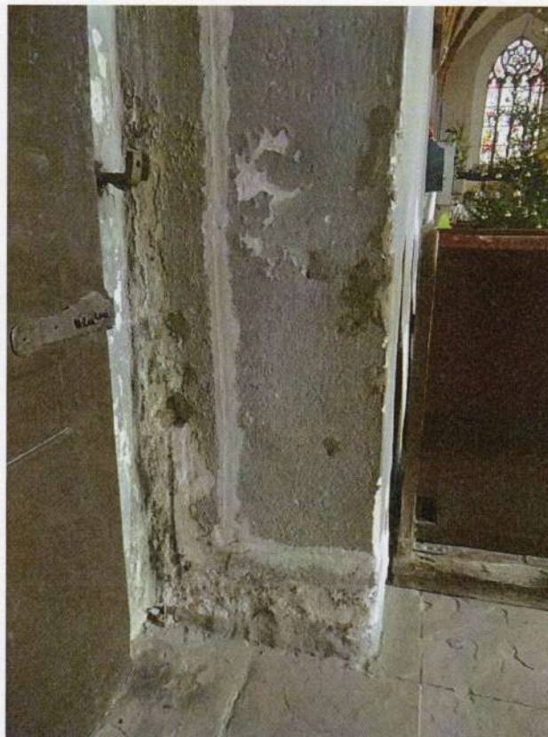
Fot.40 Uszkodzenia, rozwarstwienia i złuszczenia warstwy malarskiej
