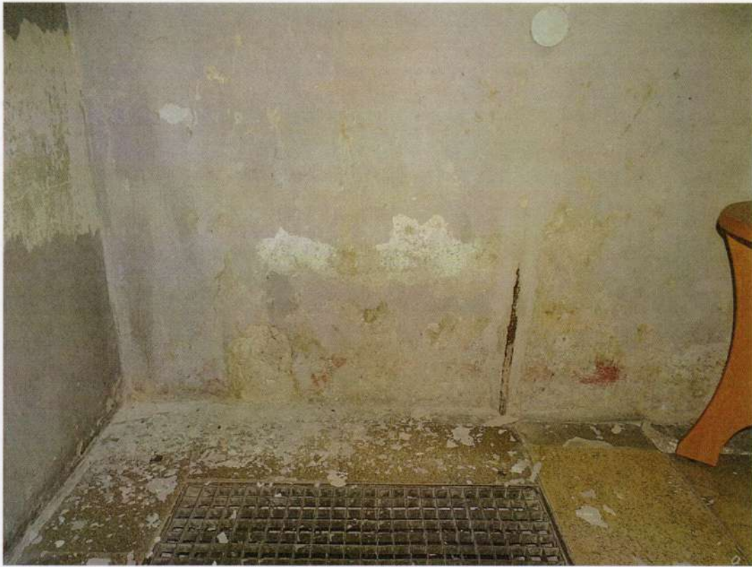
Fot.43 Uszkodzenia przyziemia w części wschodniej nawy północnej
