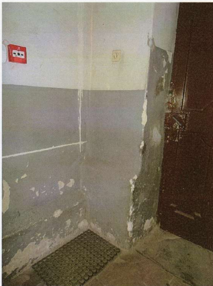
Fot.48 Uszkodzenia tynku i warstw malarskich w kaplicy Bożywojów
