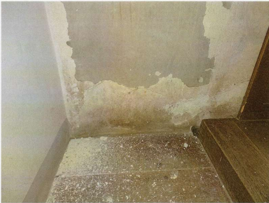
Fot.35 Uszkodzenia części przyziemia spowodowane zawilgoceniem i zasoleniem nawy
